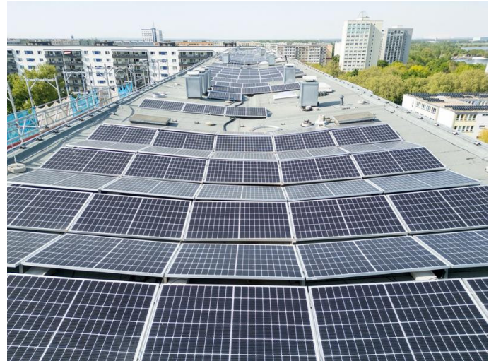
Lufbild - Photovoltaik, kurz PV-Anlage
