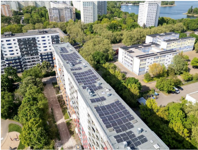
Lutbild - Photovoltaik, kurz PV-Anlage
