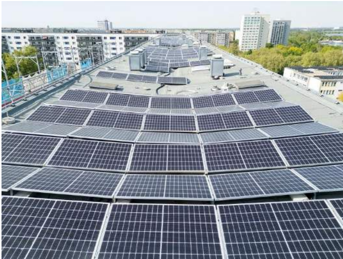
Lutbild - Photovoltaik, kurz PV-Anlage
